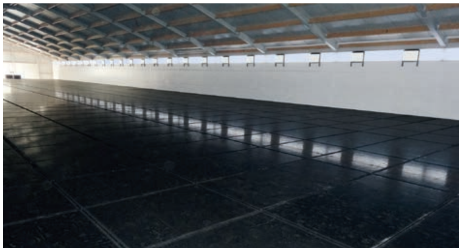
Pohled na podlaží v patře vyrobeného z plastu ještě před instalováním technologie
